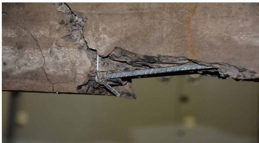
Figura 4 – Ruptura do estribo na viga reforçada com aço
